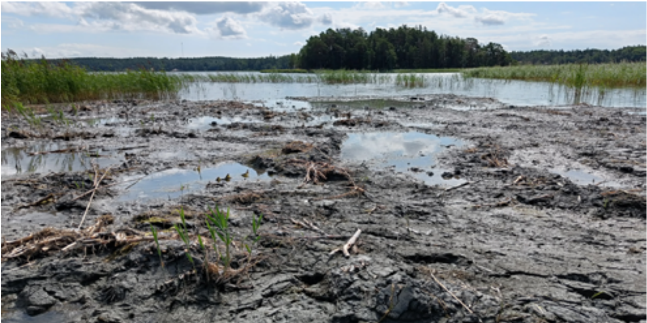
Huonosti toteutettu, ruovikkoon sijoitettu läjitys aiheuttaa sekä ympäristöhaittaa että lisäkuluja hankevastaavalle. Valvontaviranomainen lähettää kehotuksen siirtää sopimattomalle paikalle sijoitetun massan, jolloin hankevastaava joutuu tilaamaan urakoitsijan poistamaan massan. Kuva: Siiri Nyrhilä, Varsinais-Suomen ELY-keskus.
